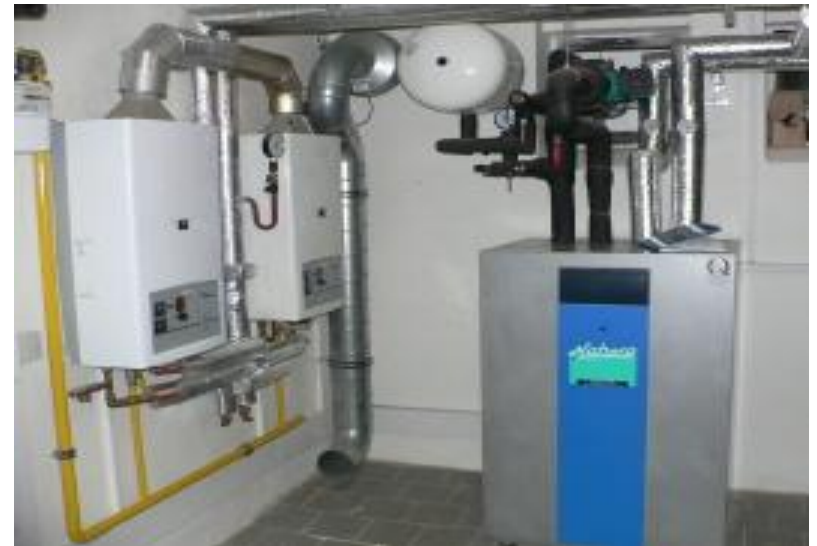
Obr. 11: Kotelna s TČ a záložními plynovými kotli [13].
